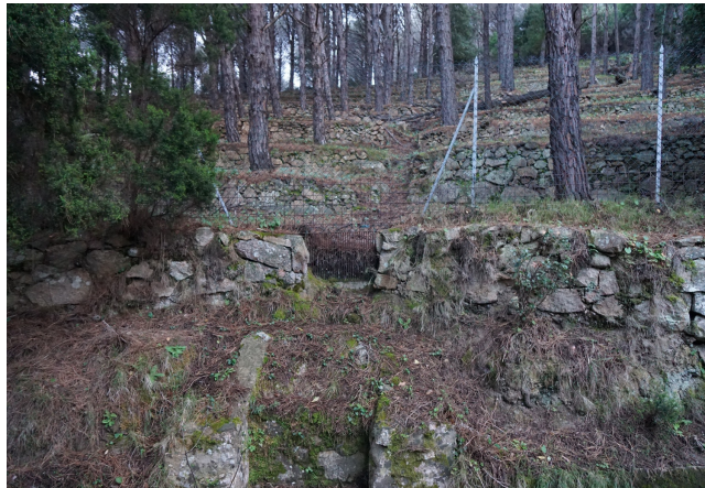
F7: Panoramiche di zone in cui sono stati ripristinati i muretti a secco e l'originaria regimazione idraulica.
