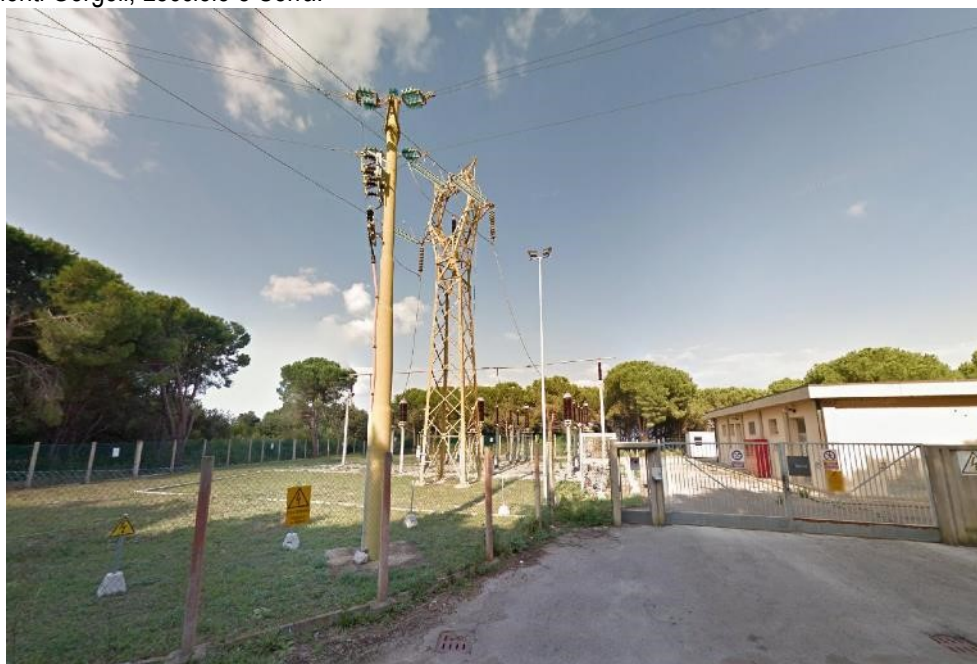
Stazione di Cala Telegrafo – Arrivo dei cavi sottomarini e partenza della linea aerea 132 kV
